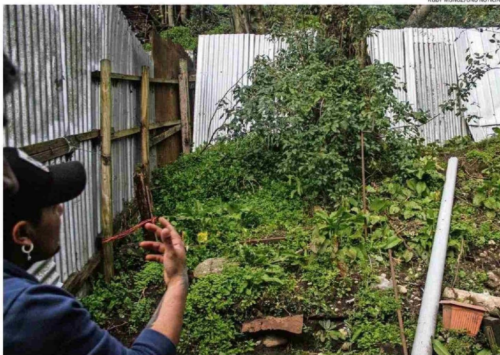
YONATHAN ALMONACID ESTÁ REALIZANDO UN CATASTRO DE LOS DAÑOS PRODUCTO DEL INGRESO DE AGUA A SU PROPIEDAD.
