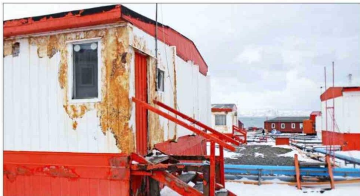
Varias de las viviendas desocupadas en 2018, afectadas por la corrosión y con instalaciones de servicios básicos deficientes, aún esperan una renovación.
