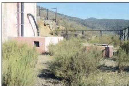
Actualmente, el sistema de APR Municipal cuenta con agua en todos sus estanques, pero el sistema es tan antiguo, que sufre pérdidas de hasta un 30%. Urge una inversión millonaria.
