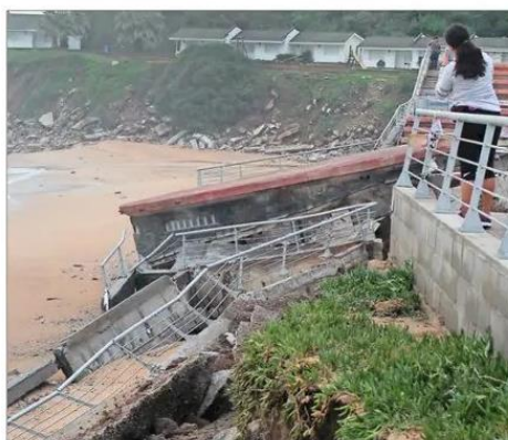
Aumento de fenómenos climáticos severos, como marejadas, erosionan la playa y destruyen la infraestructura de su entorno. En la foto, daños dejados por el fuerte oleaje en Viña del Mar.
