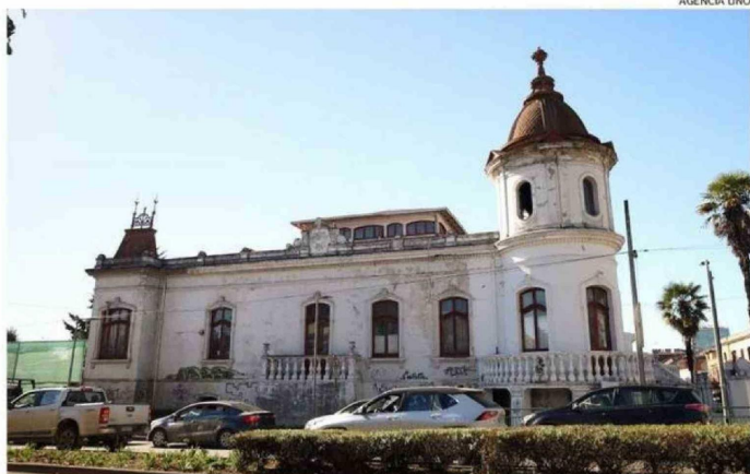
LA CASONA LUCE DETERIORADA ACTUALMENTE, CON HONGOS E INCLUSO SIN VENTANAS EN LA TORRE PRINCIPAL.
