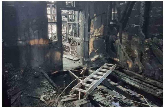
ASÍ LUCE HOY POR DENTRO EL TABLÓN DEL ANCLA. LOS DAÑOS SON TOTALES.
