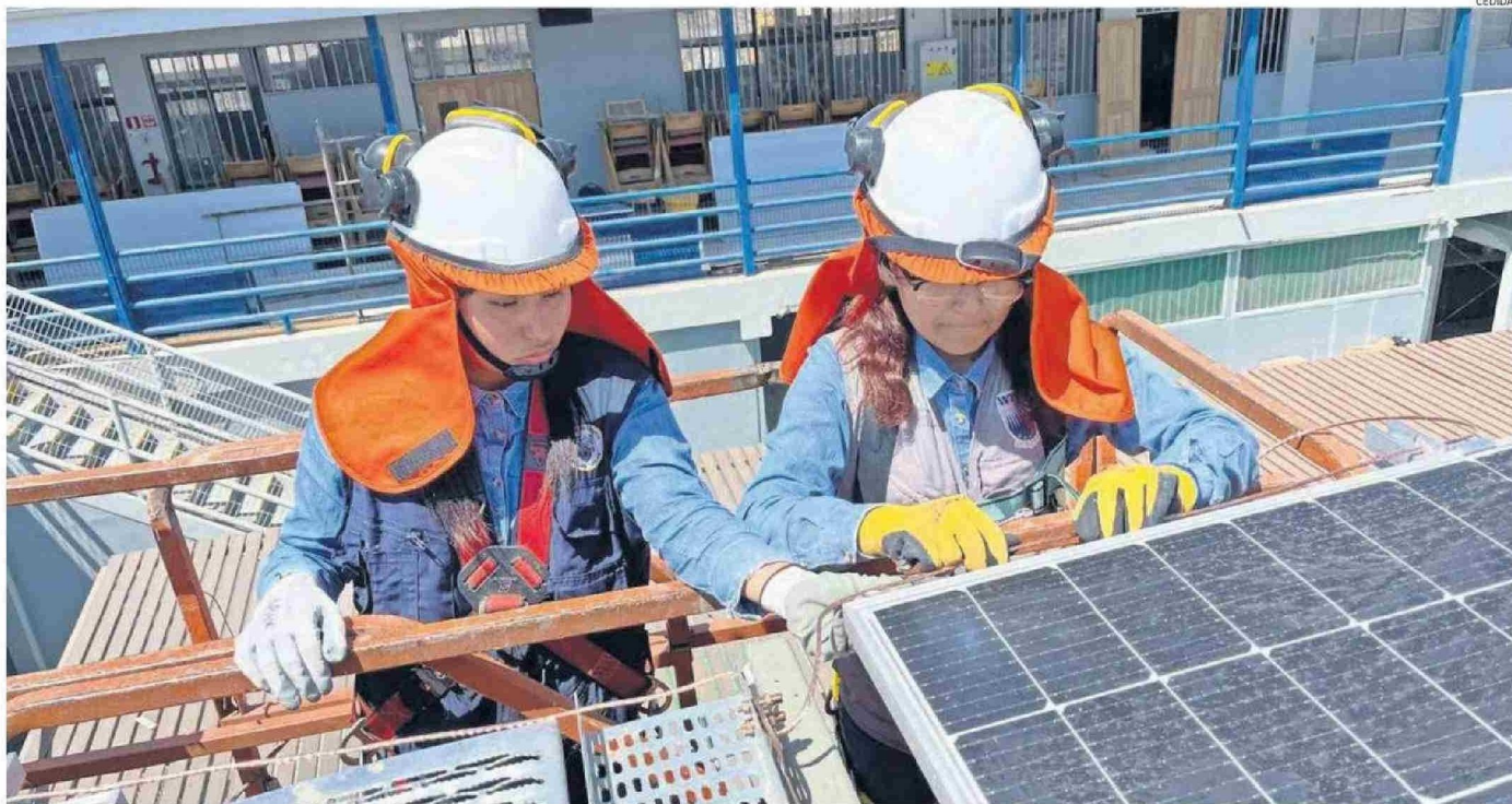
ESTA PLANTA FOTOVOLTAICA PERMITIRÁ DAR UN VALOR AGREGADO A LOS ESTUDIANTES DE LAS ESPECIALIDADES DE ELECTRÓNICA, ADMINISTRACIÓN Y TELECOMUNICACIONES.
