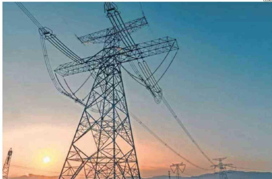
UNO DE LOS PROYECTOS ES LA LÍNEA DE TRANSMISIÓN ELÉCTRICA HVDC KIMAL-LO AGUIRRE, CON UN MONTO ESTIMADO DE US$ 1.480 MILLONES.
