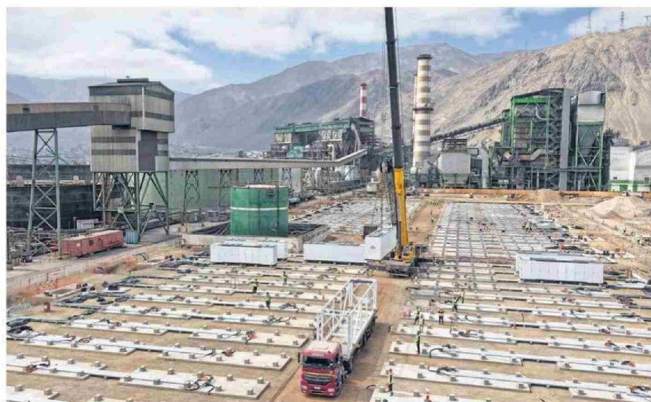
AVANCE DEL 60% EN SU PROYECTO DE ALMACENAMIENTO DE ENERGÍA, PROMOVRIENDO UN DESARROLLO SOSTENIBLE Y RESPONSABLE.
