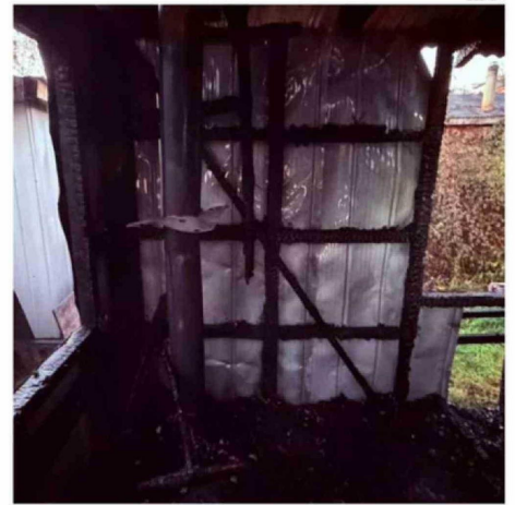
COMPLETAMENTE DESTRUIDA RESULTÓ UNA VIVIENDA.
