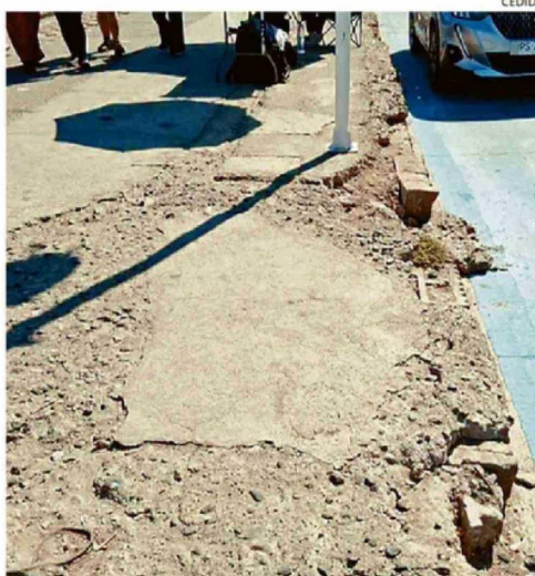
LA IMAGEN CORRESPONDE A LA TRADICIONAL AV. PERÚ. UNA VERDADERA TRAMPA MORTAL.
