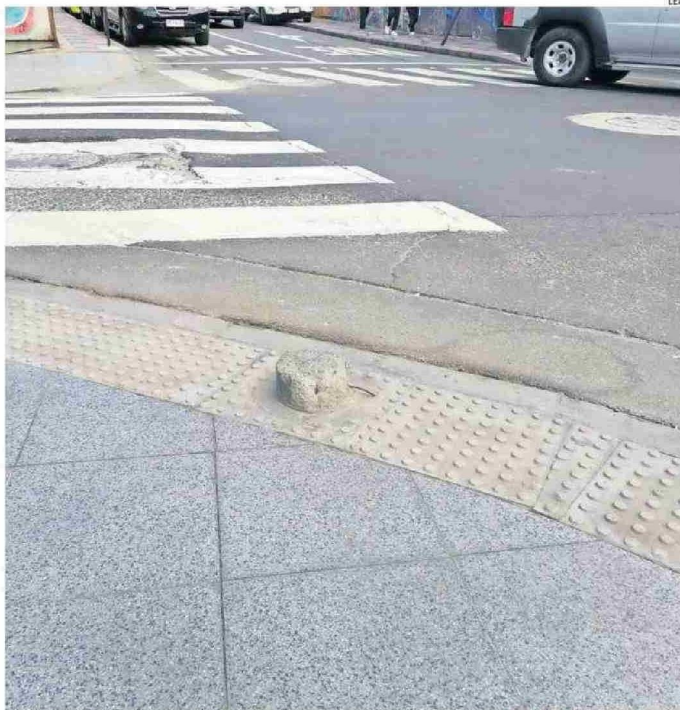
LO QUE QUEDA DE UNO DE LOS SEGREGADORES ES UN RIESGO DE TROPIEZO JUSTO AL CRUZAR.
