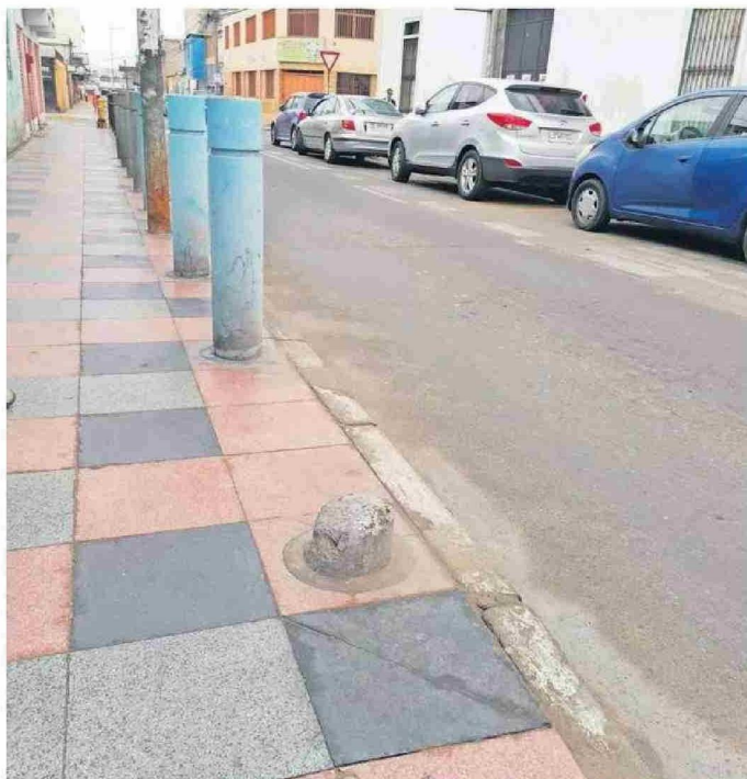
EN ESE ESTADO SE ENCUENTRAN VARIOS BOLARDOS, LEJOS DE CUMPLIR SU FUNCIÓN.
