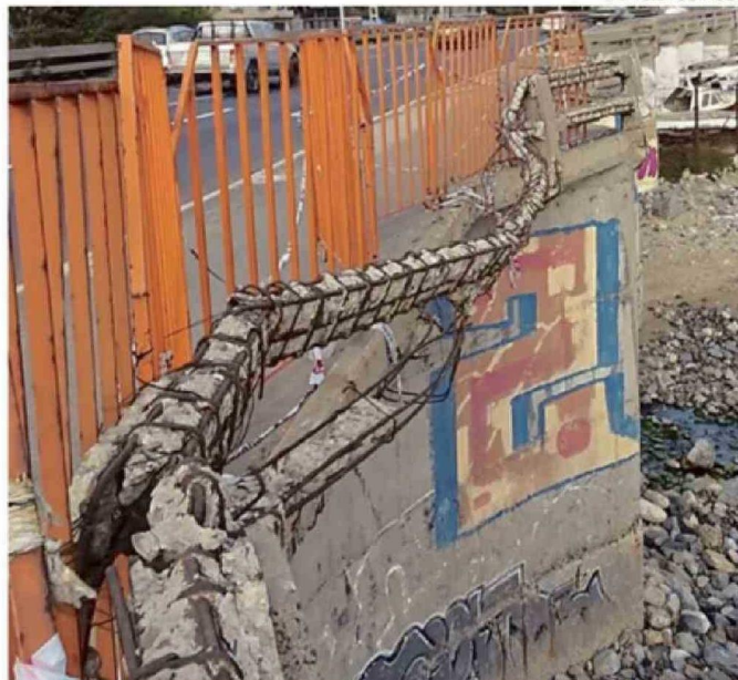
EL EVIDENTE DETERIORO EN AV. ESPAÑA.
