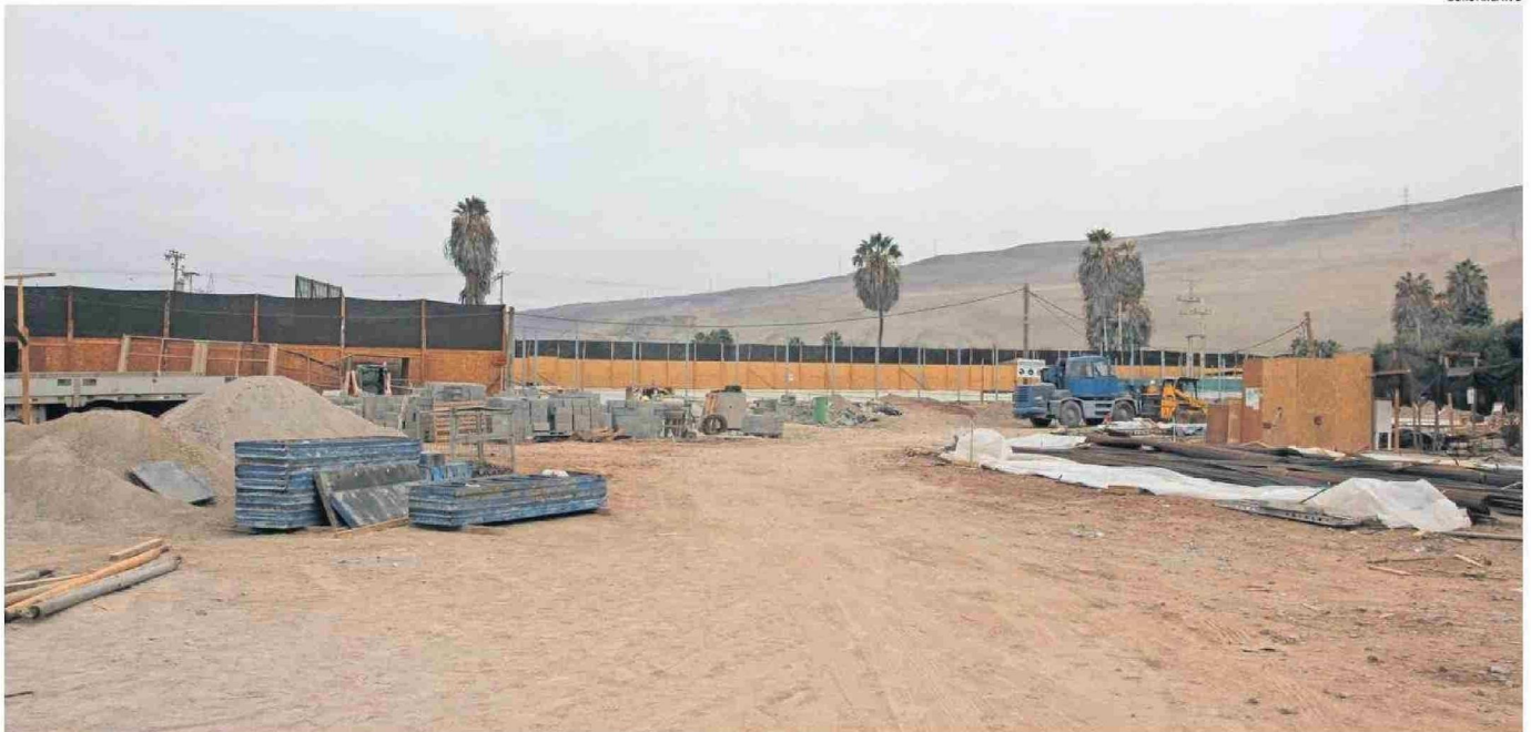
ASÍ LUCIÁN LAS OBRAS EN 2023, FECHA EN QUE LOS TRABAJOS DE ESTA OBRA EMBLEMÁTICA PARA LA REGIÓN QUEDARON PARALIZADAS.
