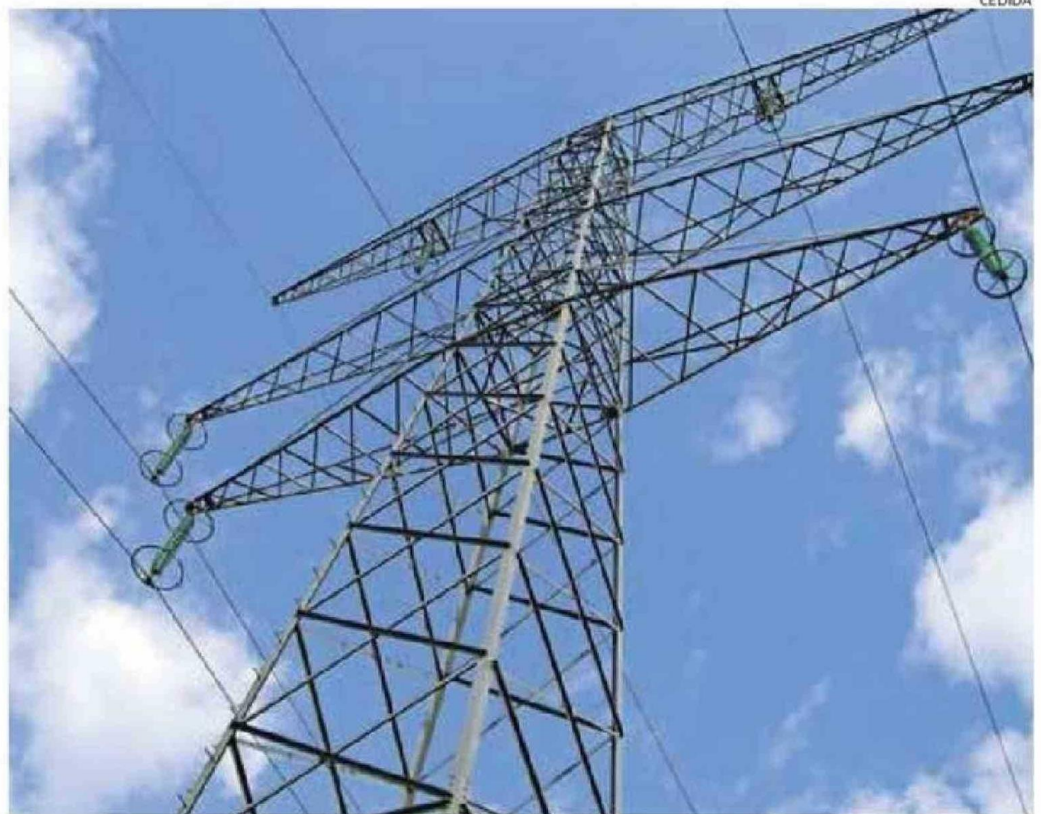
ENTRE LAS OBRAS PERMANENTES SE CONTEMPLAN 409 ESTRUCTURAS PARA LA LÍNEA DE TRANSMISIÓN.
